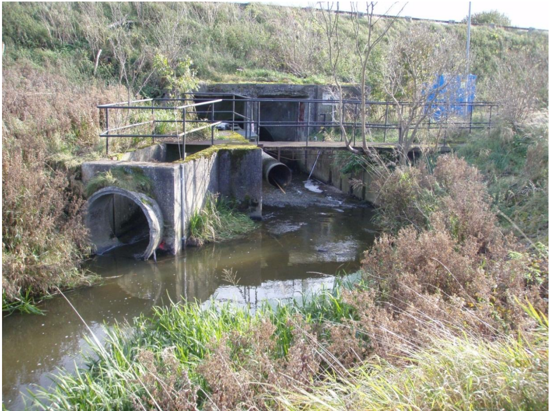
Bild 1. Tryckgivaren är placerad i ett rör något till höger om närmaste betongkulverten.
